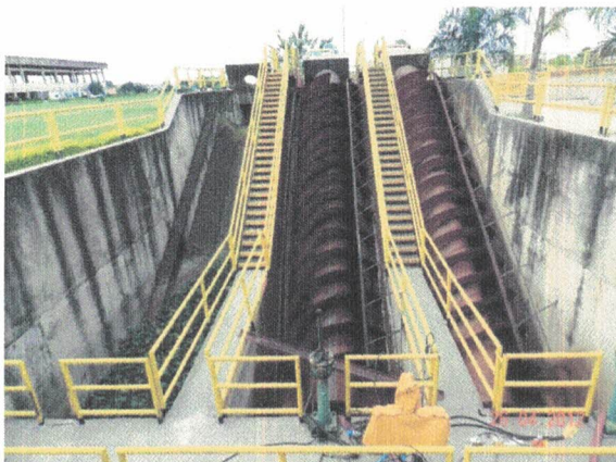
Figura 35 - Elevatória de recirculação de lodo
