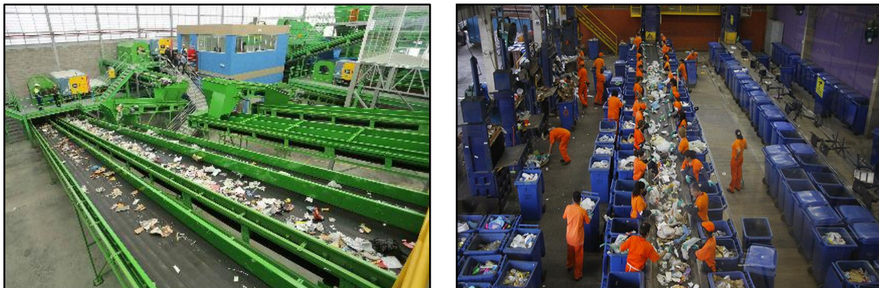
Figura 51 – Centro de Triagem de Resíduos Sólidos - CTRS e segregação de resíduos recicláveis e não recicláveis.
