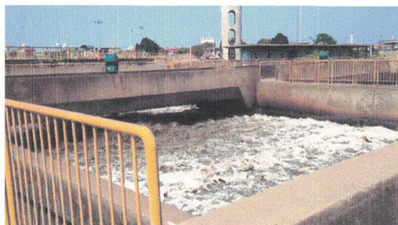
Figura 33 - Tanque de Aeração
