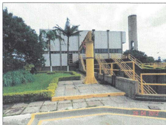
Figura 29 - Elevatória de Esgoto Final
