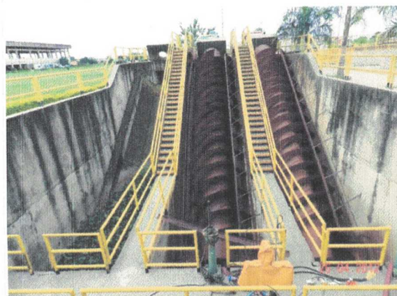
Figura 36 - Elevatória de recirculação de lodo
