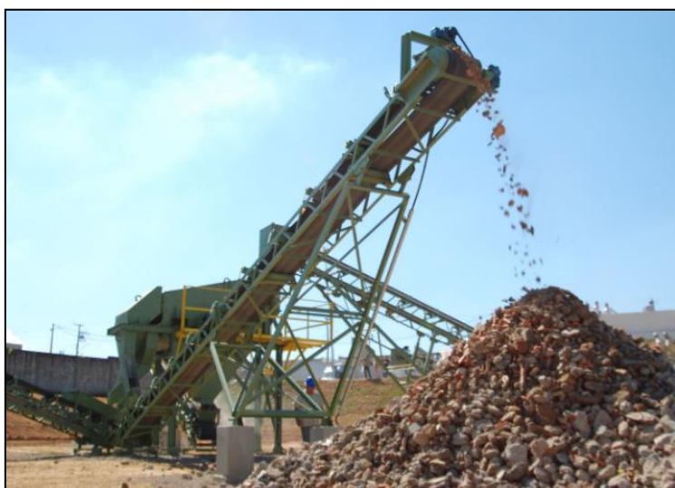
Figura 73 – Usina fixa de RCC.
