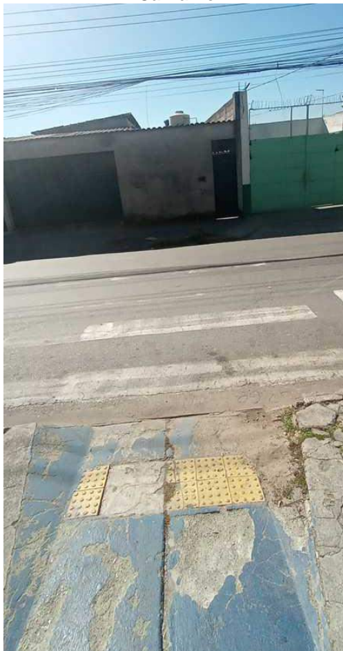
Figura 48 – Trecho com faixa de pedestre carente de manutenção - R. Leonor Barroso de Carvalho
