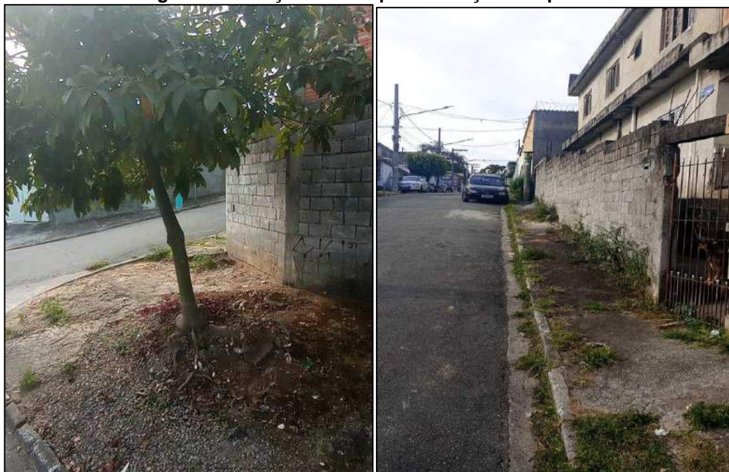
Figura 88 – Calçada sem a pavimentação adequada.
