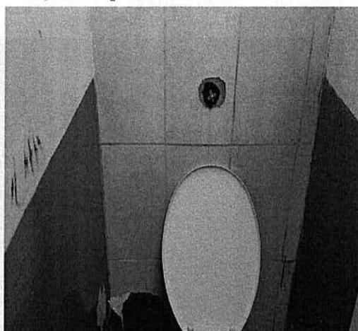
Banheiro sem descarga.
