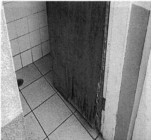
Porta do banheiro deteriorada.
