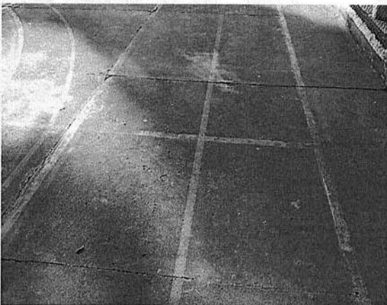
Quadra com piso irregular e quebrado.
