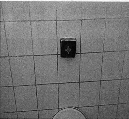
Banheiro sem acabamento da descarga.
