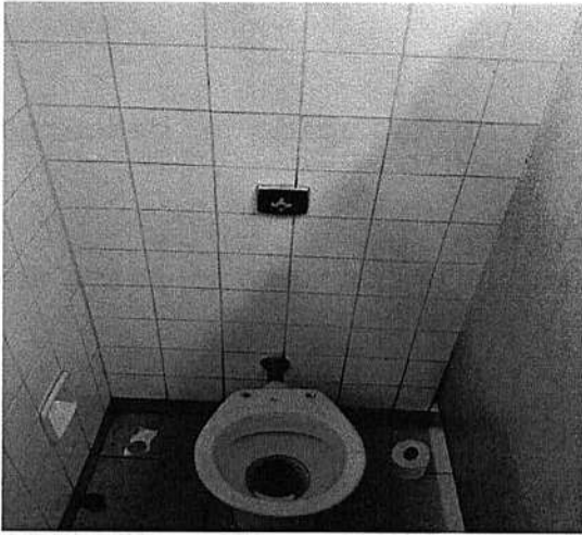
Banheiro interditado, entupido e com descarga quebrada.
