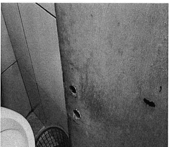
Porta do banheiro sem maçaneta e tranca.
