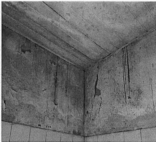
Infiltrações no banheiro.
