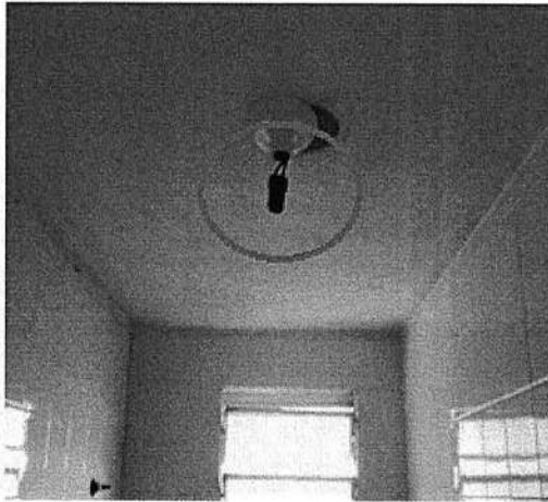
Banheiro sem lâmpada.
