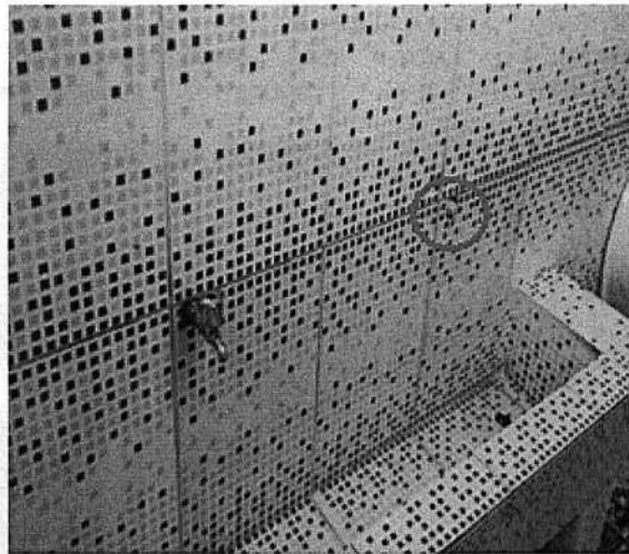
Falta de torneira.
