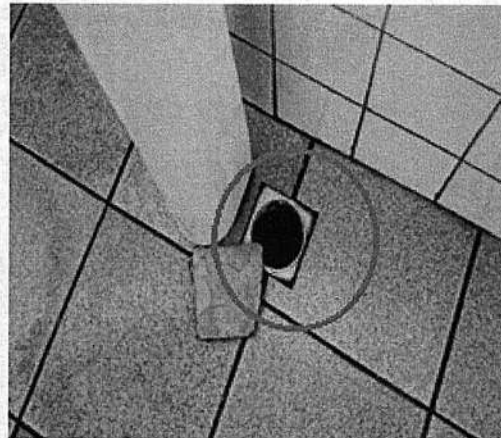
Ralo do banheiro sem tampa.
