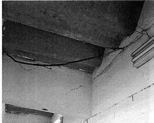
Fiação exposta na sala de aula.
