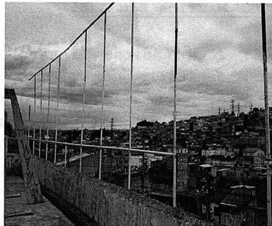
Muro da quadra sem tela de proteção.
