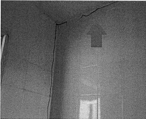
Rachaduras na parede do banheiro.
