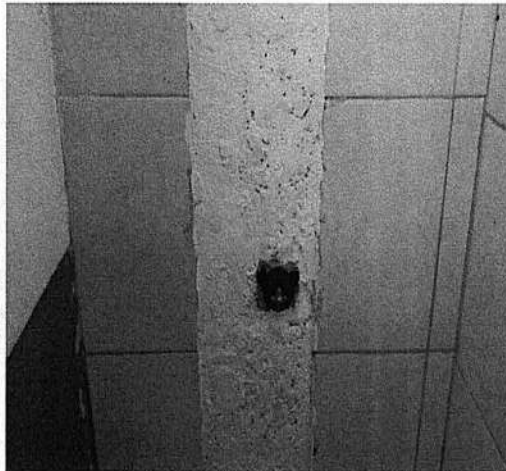
Parede e válvula sem acabamento e revestimento.
