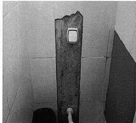
Parede sem revestimento.
