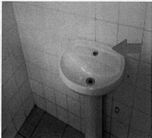
Pia do banheiro sem torneira.
