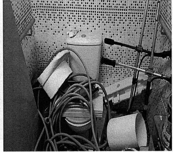
Banheiro para deficiente físico utilizado como depósito.
