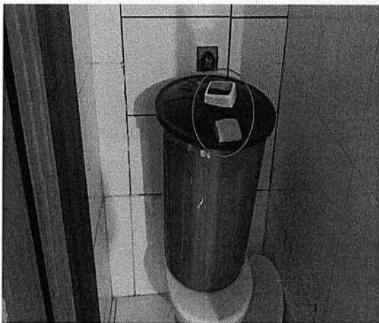
Banheiro interditado, entupido e descarga quebrada.
