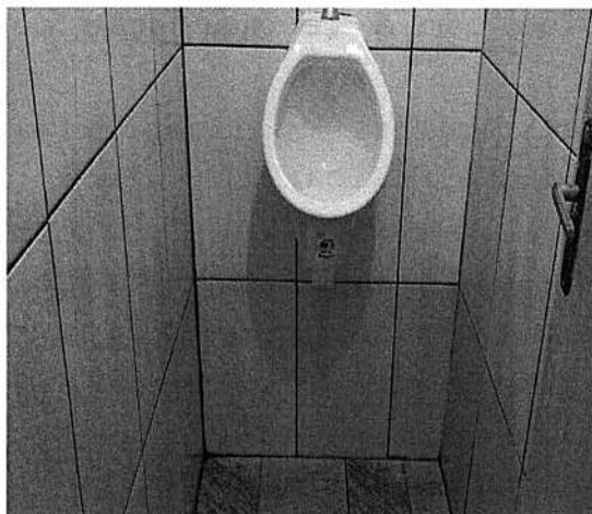
Mictório com altura inadequada (muito alto).
