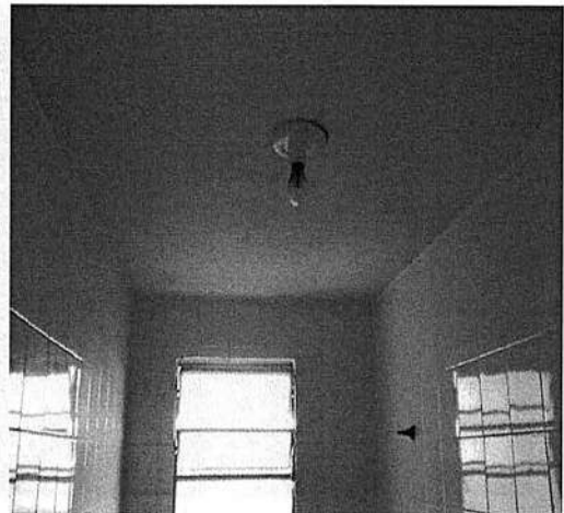
Banheiro com lâmpada queimada.
