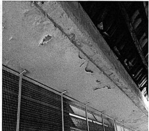
Calha do telhado com infiltrações.
