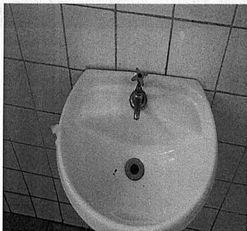
Falta de água na escola.
