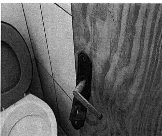
Maçaneta do banheiro deteriorada.
