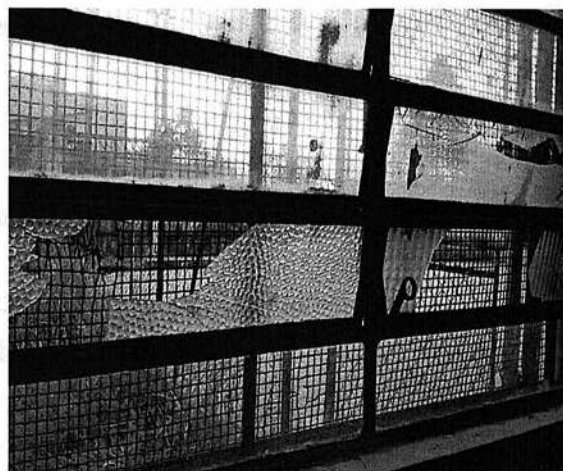
Janelas com vidros quebrados.
