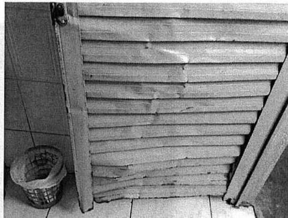
Porta de entrada do banheiro danificada.
