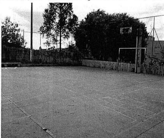
Quadra sem pintura demarcatória e sem tabelas.
