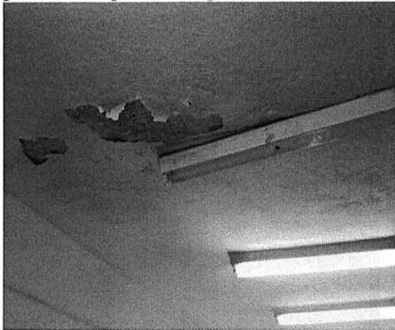
Teto com infiltração na sala de aula e falta da lâmpada.
