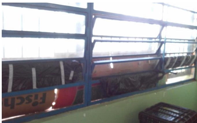
Foto 35 – Janela da cozinha danificada e vedada com papelão
