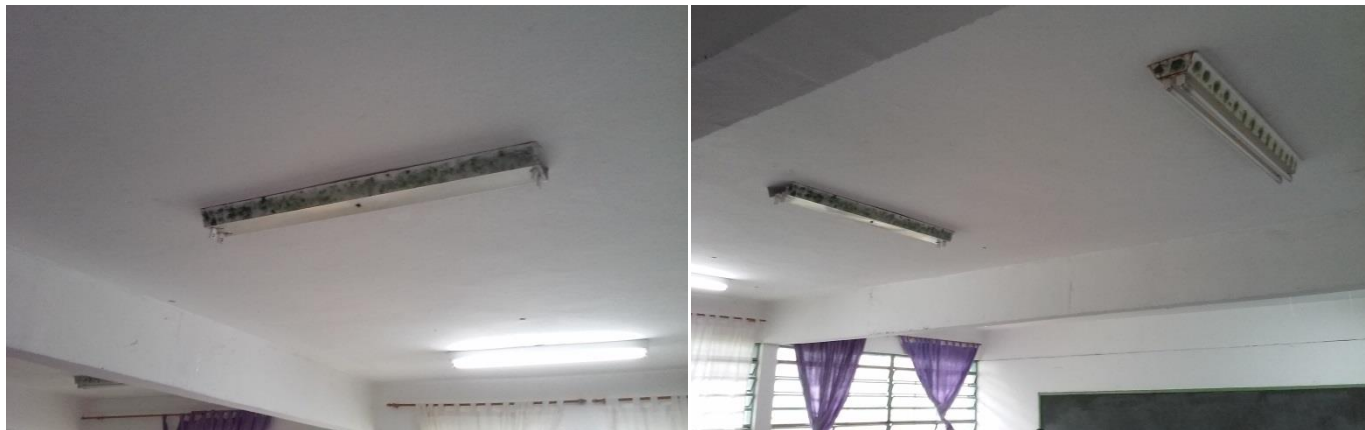
Fotos 05, 06 - Salas de aula sem lâmpadas
