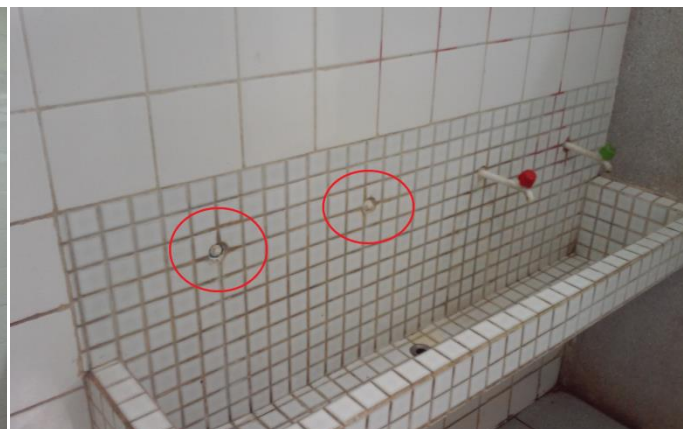
Foto 34 – Banheiro faltando torneiras
