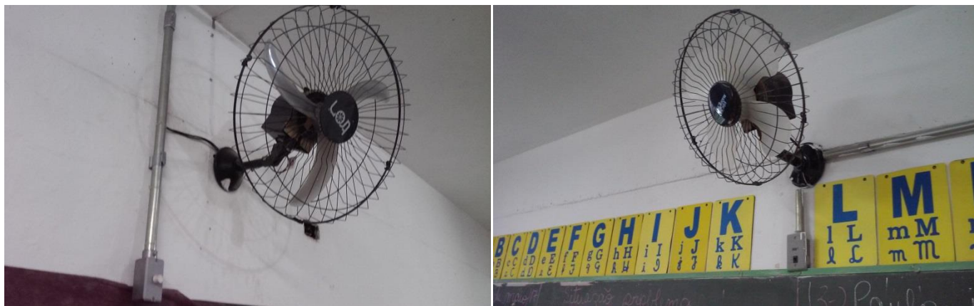
Fotos 09, 10 - Salas de aula com ventiladores quebrados
