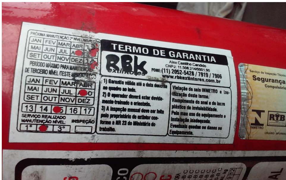
Foto 1 – Extintor com carga vencida desde agosto/2015
