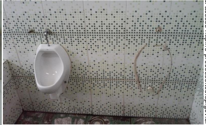
Foto 18 – Sanitário faltando mictório
