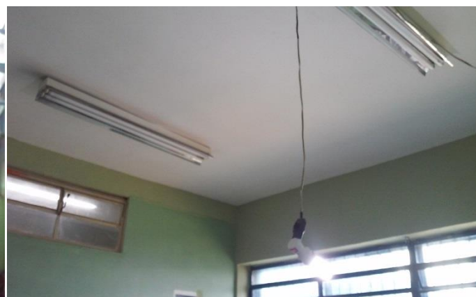
Foto 36 – Cozinha sem iluminação e com instalação elétrica improvisada
