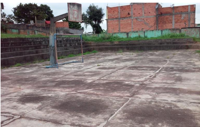
Foto 21 – Quadra poliesportiva interditada e sem condições de uso: pisos irregulares e quebrados, tabela e trave danificadas
