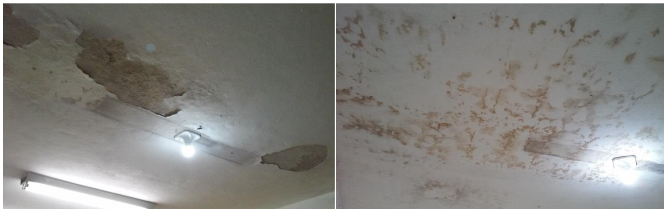
Fotos 07, 08 - Salas de aula com infiltrações nos tetos
