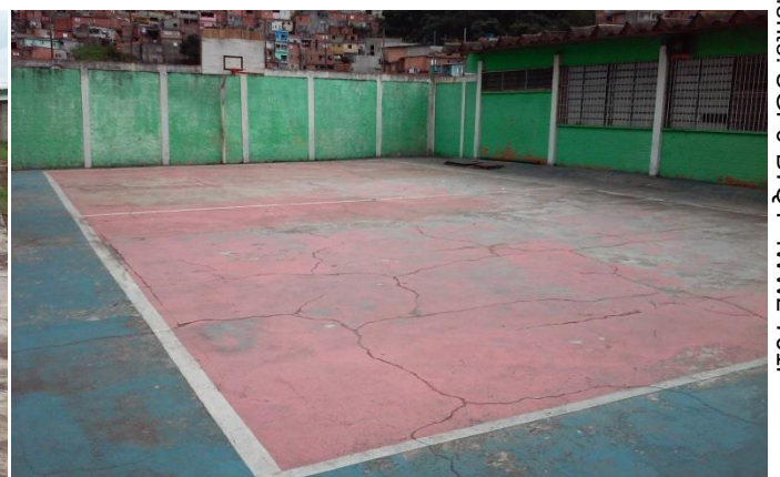
Foto 22 – Espaço improvisado como quadra com pintura do piso desgastada, sem traves, piso irregular e com rachaduras
