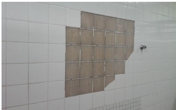
Foto 33 – Parede do banheiro com revestimento danificado
