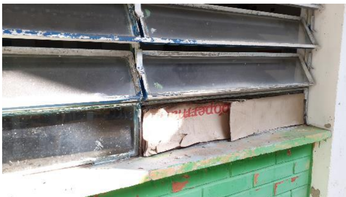
Janelas de salas de aula com vidros faltantes
