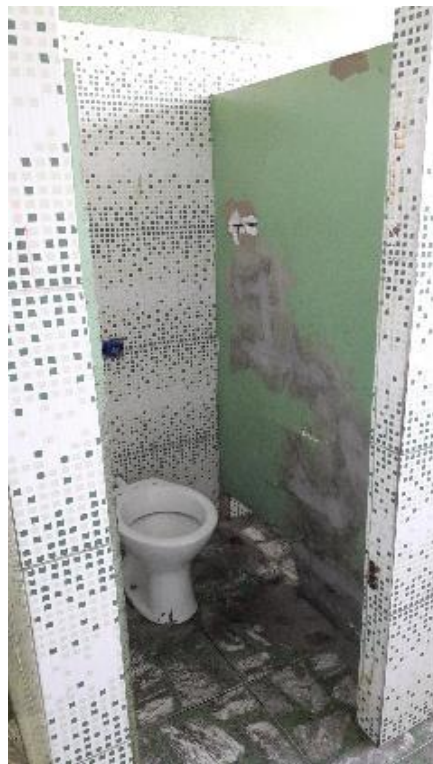
Sanitário masculino sem porta e sem assento
