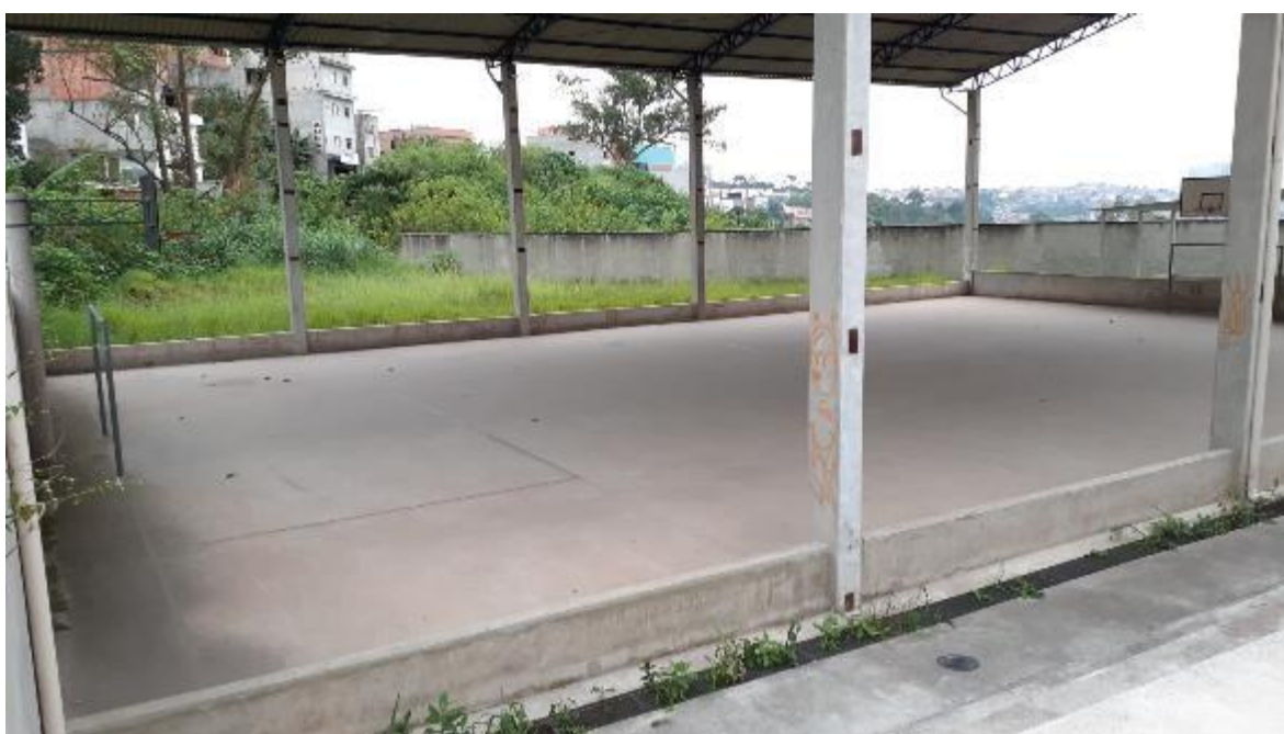
Quadra com mato alto (ao fundo) e vegetação crescendo na canaleta de escoamento de água
