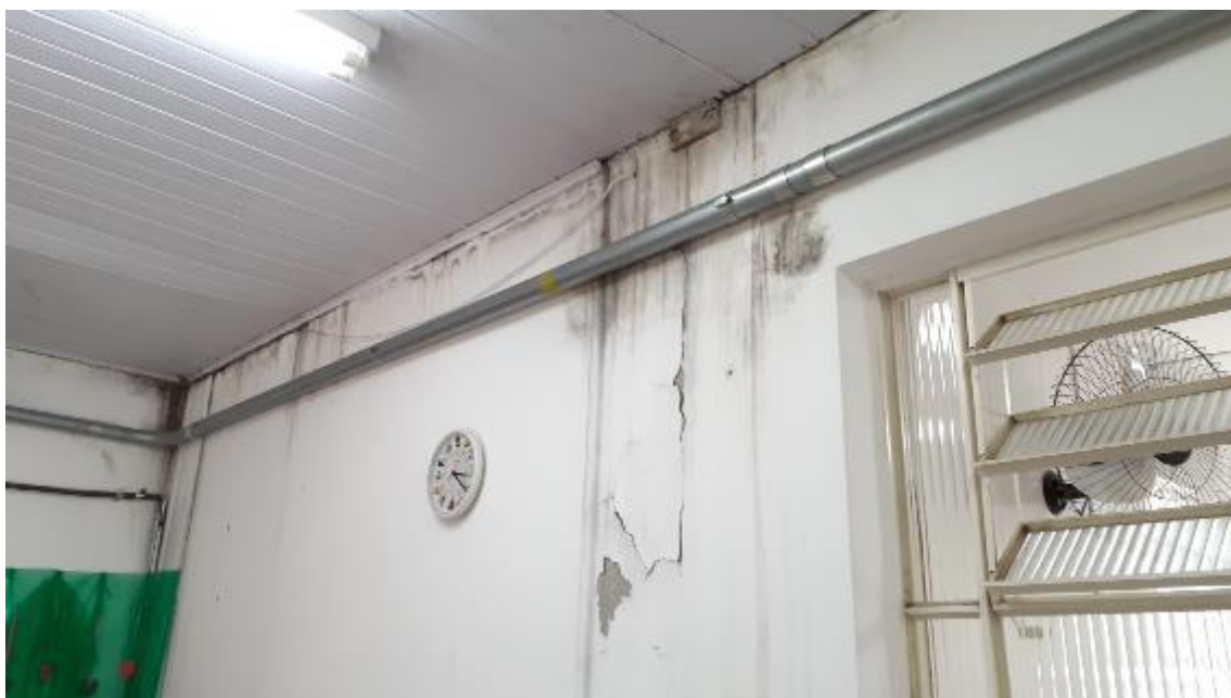
Manchas de umidade no teto e paredes
