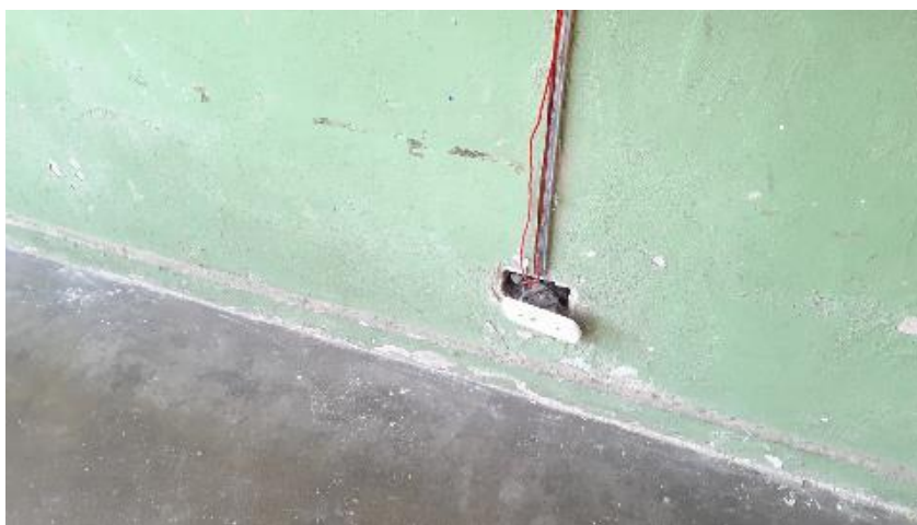
Fiação exposta em sala de aula
