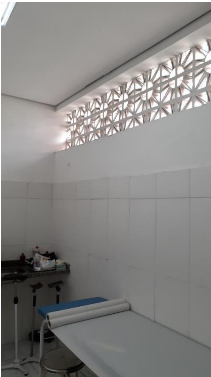
Sala de medicação – os blocos são vazados para ventilação. Em dias de chuva forte a água da chuva entra na sala de medicação.
