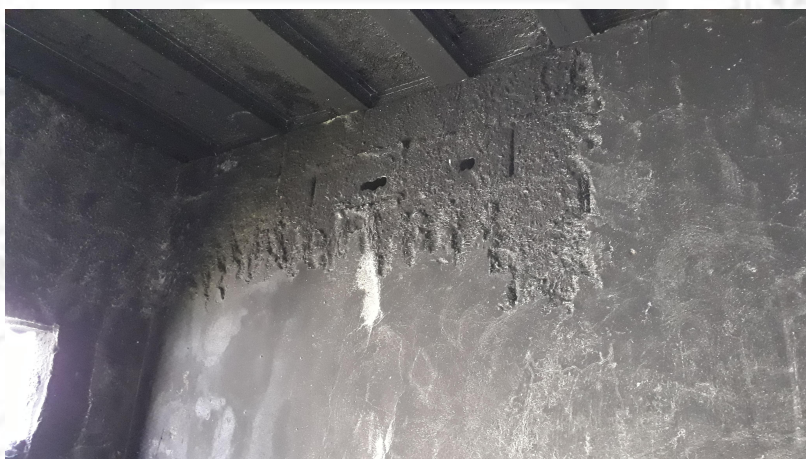
Revestimento de parede destacado em função de ação do fogo
