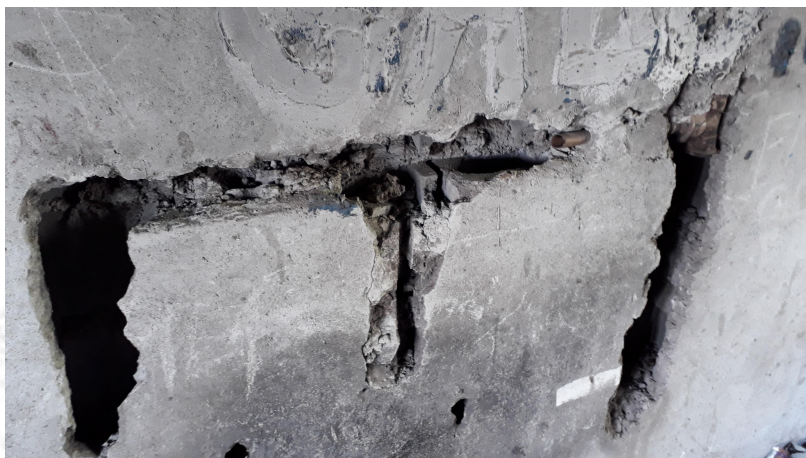
Tubulação danificada e furtada
