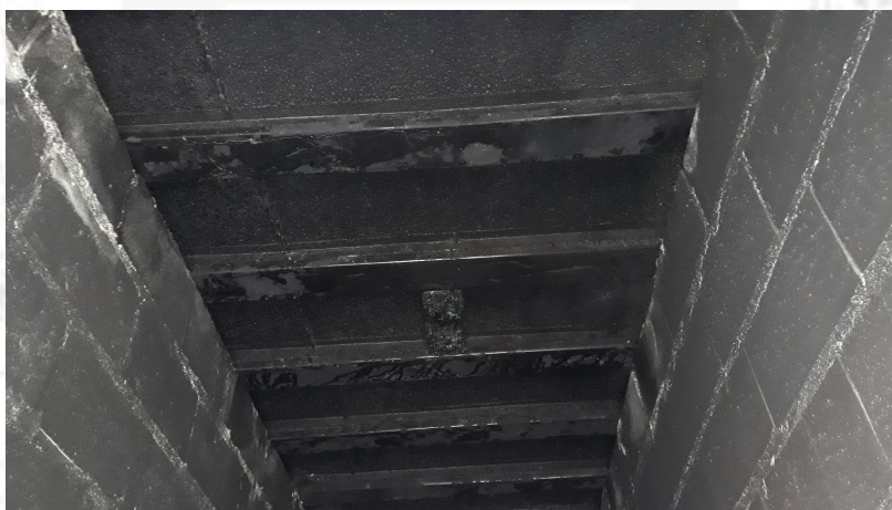
EPS de preenchimento derretidos
