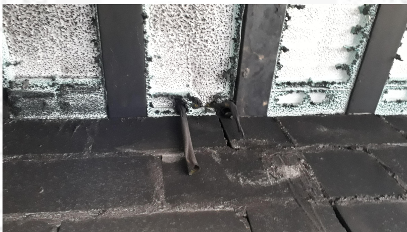
Eletroduto flexível corrugado danificado com o fogo
