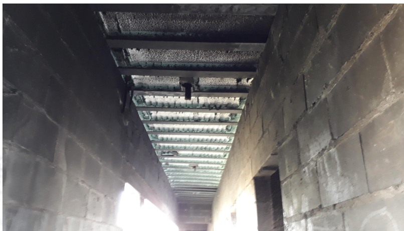
EPS de preenchimento derretidos
