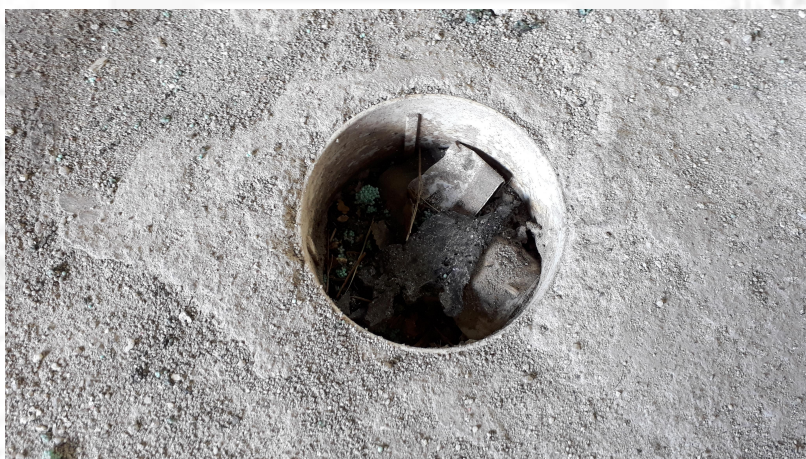
Ralo e tubulação de esgoto totalmente obstruída
