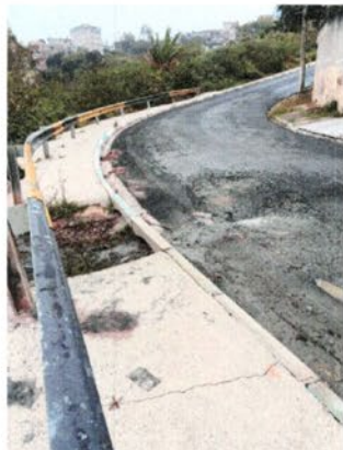
Rua Osmundo Torquato recompor o pavimento, base, sarjeta e a calçada
